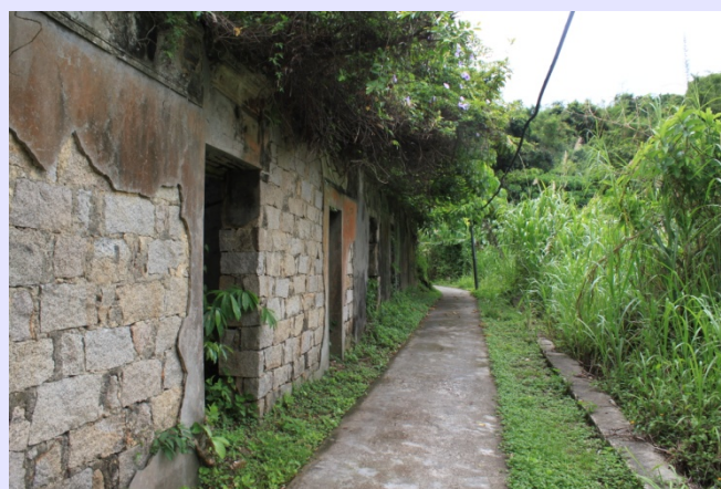
試點保育計劃：榕樹下舊村即將重建的兩棟已倒塌村屋
